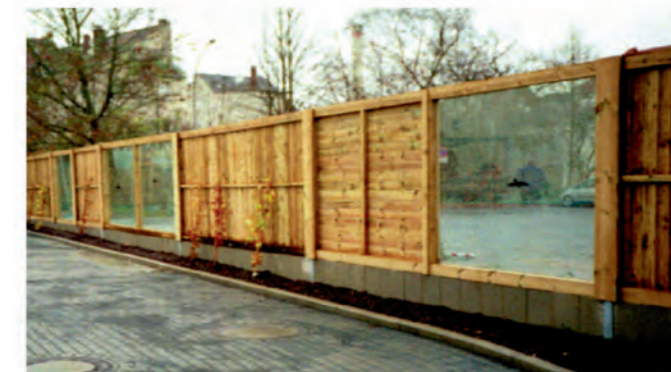
Lärmschutzwand aus Holz mit Acryl
