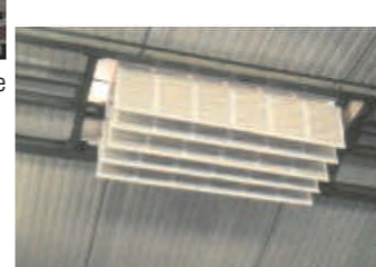
Deckenabsorber in einer Giesserei
