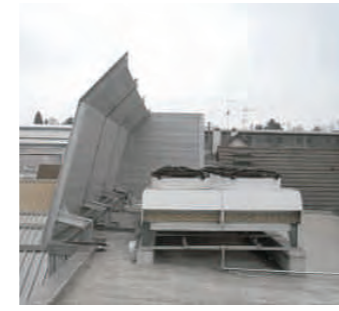
Lärmschutzwand vor Kühlaggregat
