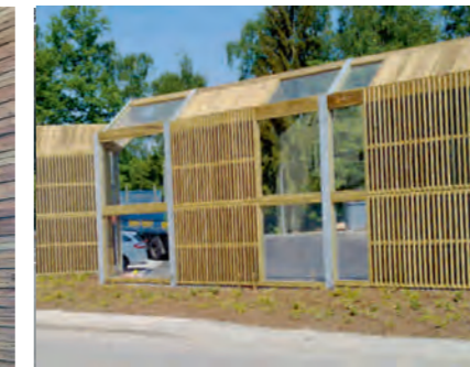
Lärmschutzwand an einer Tankstelle
