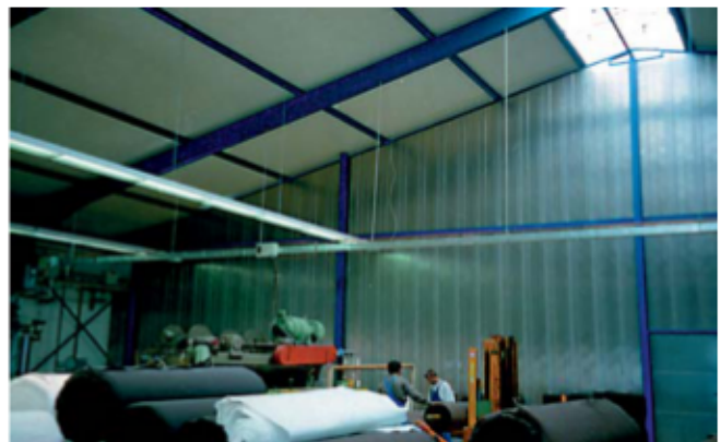
Lärmschutzwand in Fertigungshalle
