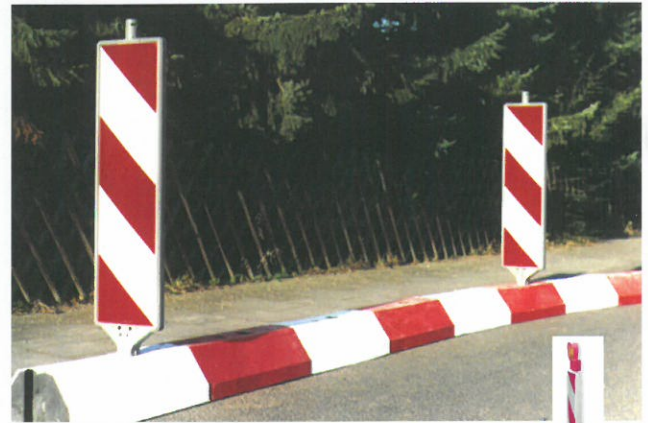
Leitbord mit TL-Baken ausgerüstet Guide separator, equipped with alignment marker
